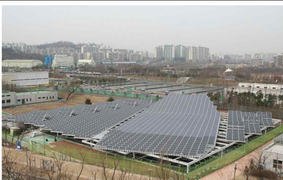
태양광 발전설비 전경사진
