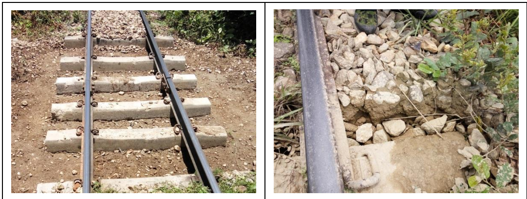
침목하부 자갈도상 토사유입 전경
