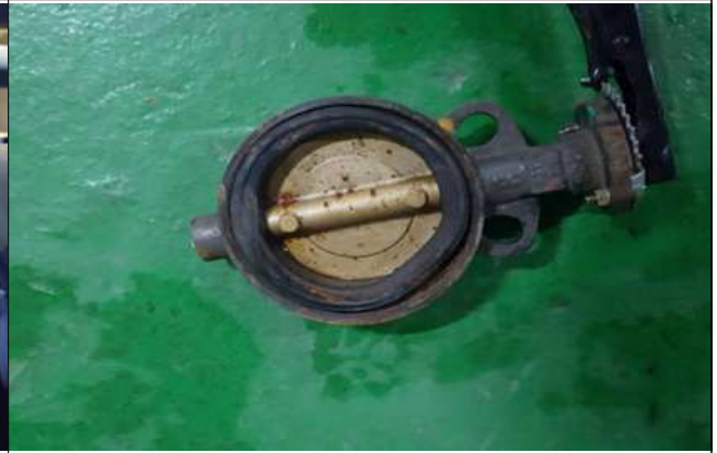
제1수영장 오버플로우 버터플라이밸브
