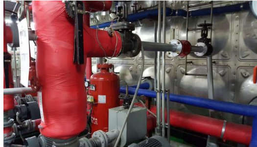
소방 펌프 성능시험배관 교체 전
