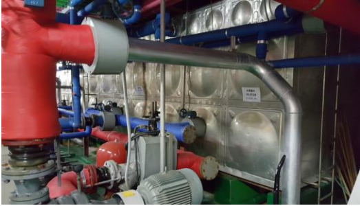
소방 펌프 성능시험배관 교체 전
