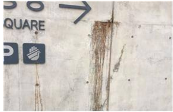
노출콘크리트 크랙 및 오염발생
