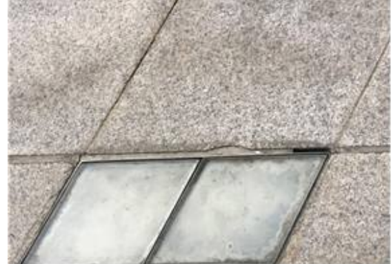
바닥 화강석 줄눈 오염 발생
