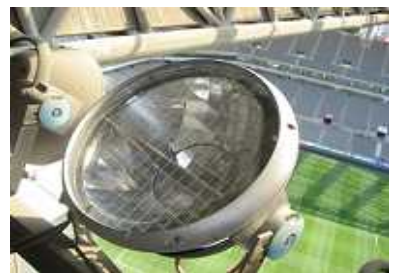
경기장 투광등 사진 (상부촬영)
