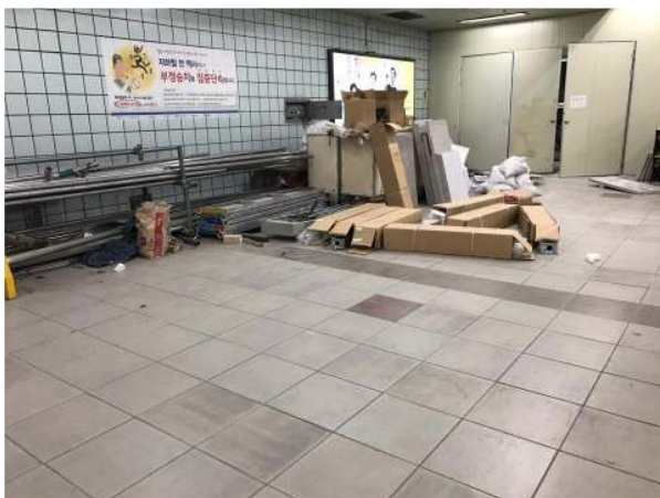
공사현장 폐기물, 현장정리 미흡(보완전)
