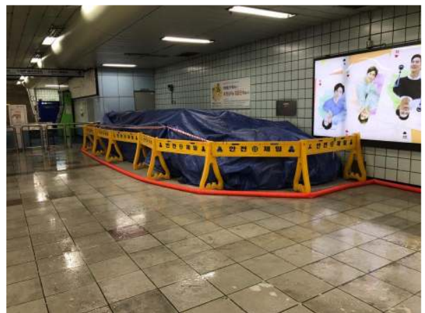
공사현장 폐기물, 현장정리 미흡(보완후)
