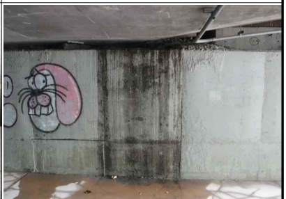
교대 - 누수흔적 및 체수
