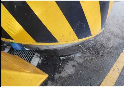
교면포장 - 실링재 파손(차도부)
