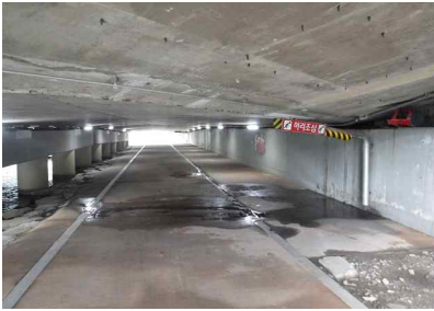
배수시설 - 배수관 설치불량
