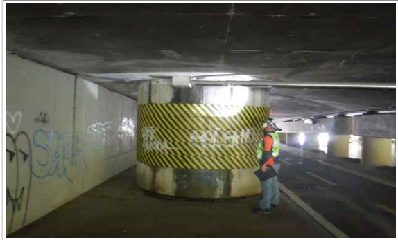
교각 접합부 하부 - 누수 및 오염
