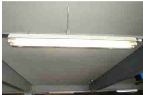
디밍 안정기 설치 후
