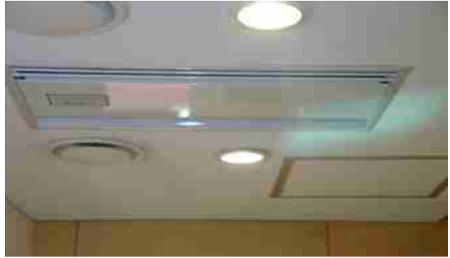
FCU 설치 후
