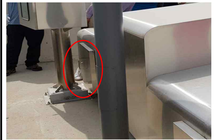
17. 권양기 제어반 내부 배기팬 및 조명 설치필요
