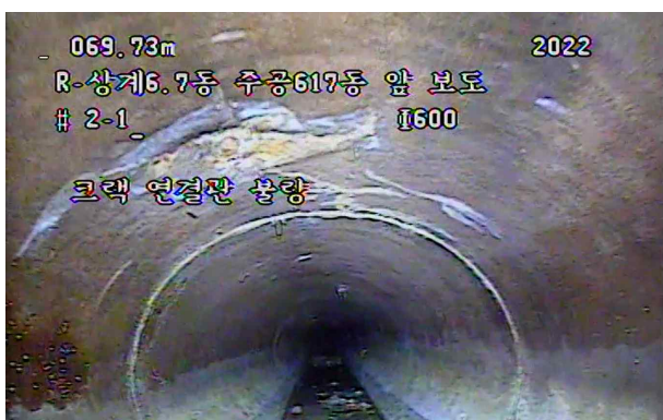
관로 상단부 파손
