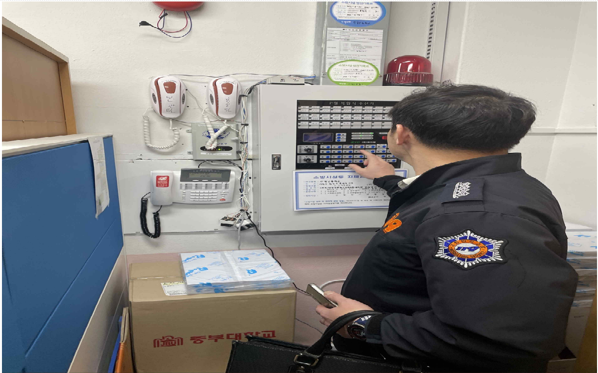
자동화재탐지설비 화재수신기 점검
